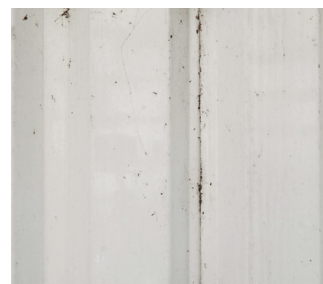
Superficie prima della pulizia
